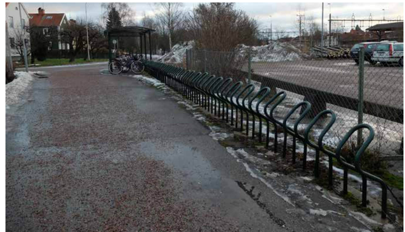
Skillnad i beläggning mellan södra (övre bild) och norra (nedre bild) cykelställen vid västra uppgången till plattform.
